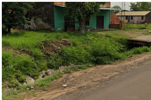
Figura N° 9. PK 0+100 Condición del desagüe pluvial.
