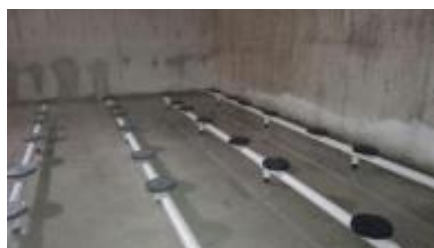
Figura 1. Sistema de aireación
