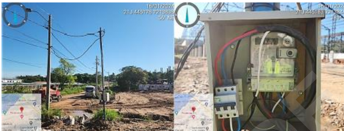
Fotografía 2. Bajada de electricidad.
