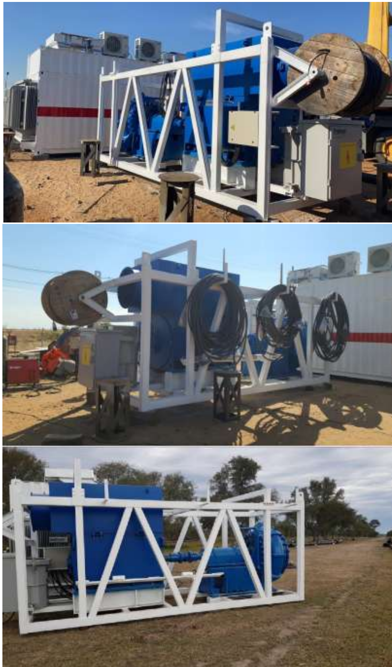
Imagen 5. Ejemplos de equipo de rebombeo
