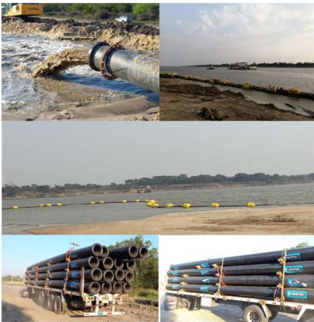
Imagen 8. Ejemplo de Tuberías y flotadores
