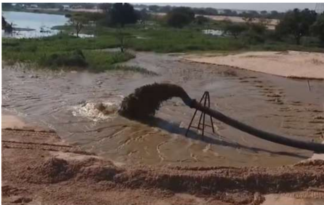
Imagen 65. Ejemplo de tubería de descarga sobre trípode metálico (foto archivo)
