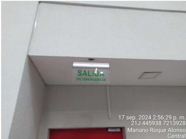
Vista generales de extintor, salida de emergencias y señalización
