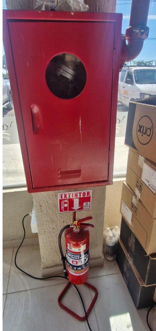
Hidrante y extintor
