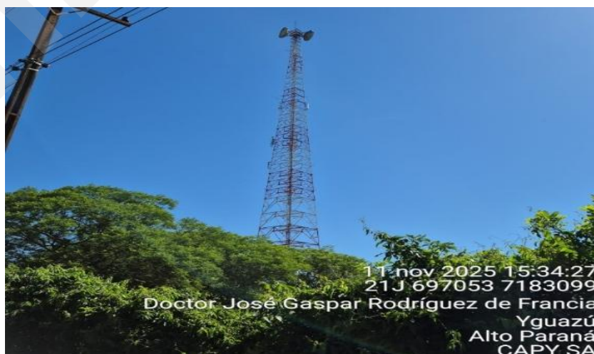
En el área de influencia indirecta se encuentran varias antenas de telefonía y comunicaciones.
