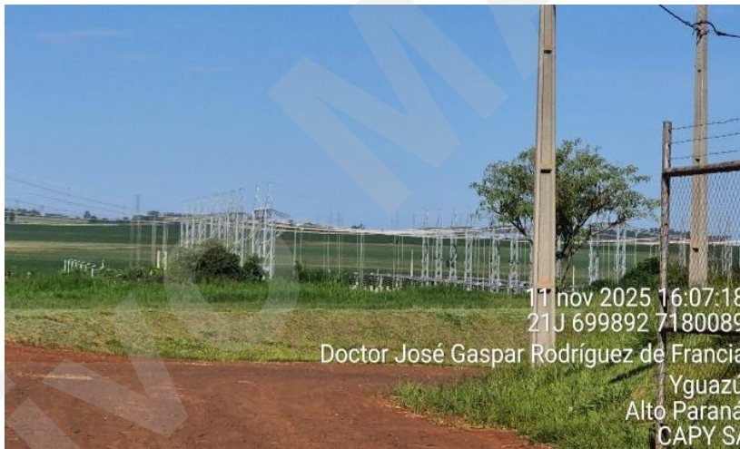
Sub Estación Yguazú de la ANDE
