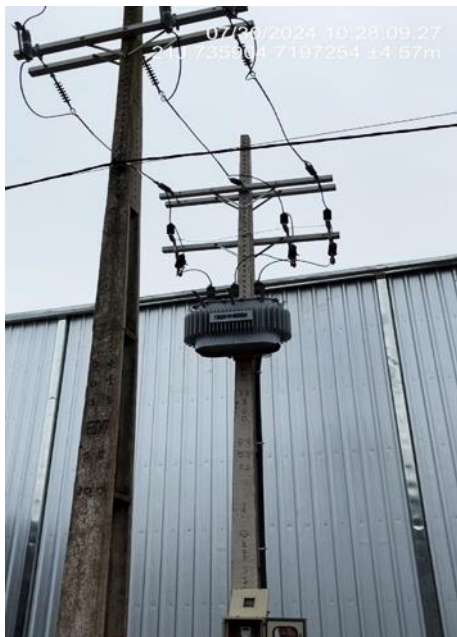
Vista del transformador y coordenadas UTM
