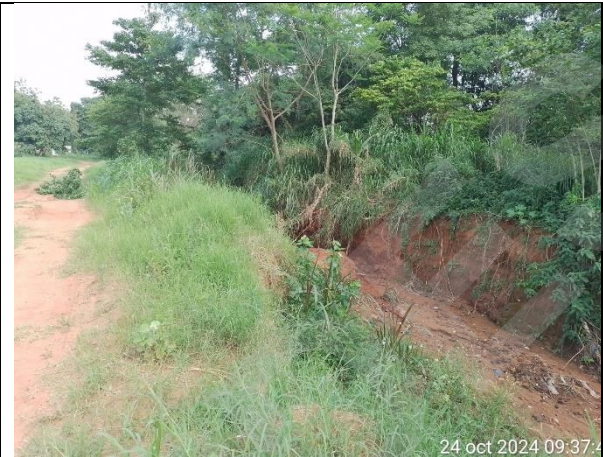
Canal actual de desagüe dentro del predio con erosiones de las márgenes.
