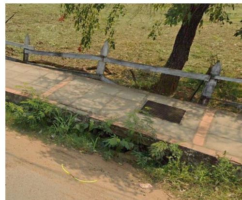
Figura N° 13. PK 0+200: Condición del desagüe pluvial.
