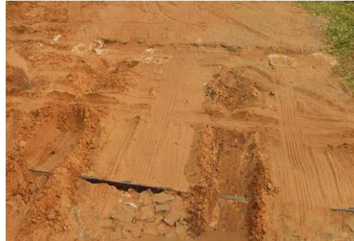
Figura N° 15. PK 25+800 Incertidumbre de las condiciones de las vías férreas y erosión del suelo.
