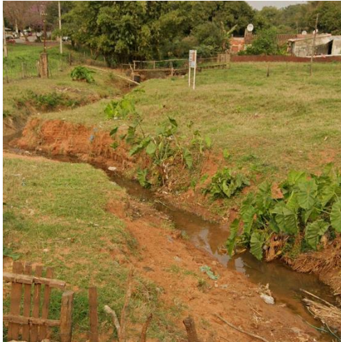
Figura N° 20. Pk 25+200 Suelo erosionado.
