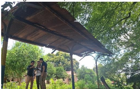
Figura N° 24. Pk(23+300) Condiciones de la parada Binder.
