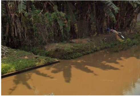
Figura N° 14. PK 11+800 Condición del desagüe pluvial.
