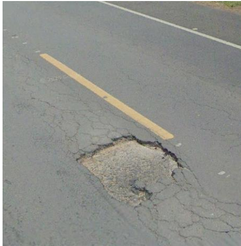
Figura N° 19. PK 7+200 Deterioro de pavimento en varios puntos de la ruta.
