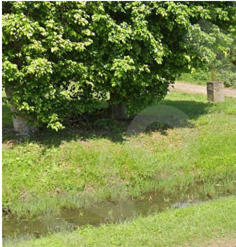
Figura N° 15. PK 11+800 Deficiencia en el drenaje fluvial, especialmente en zonas con obras de drenajes colmatadas de sedimentos, escombros y basura.
