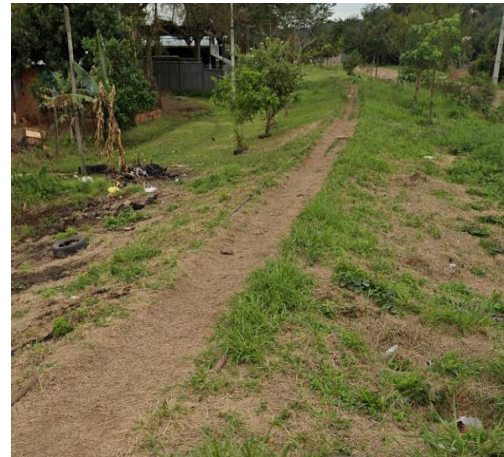
Figura N° 24. Incertidumbre sobre la localización y condición de las vías férreas en zonas donde el pavimento u otros materiales las cubren (Pk 28+400).
