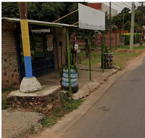
Figura N° 27. Deterioro de veredas (Pk 31+700).
