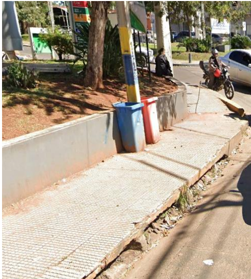
Figura N° 15. Deficiencia en el drenaje fluvial, colmatación, escombros y basura (Pk 28+900).
