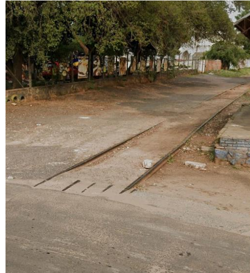
Figura N° 26. Incertidumbre sobre la localización y condición de las vías férreas en zonas donde el pavimento u otros materiales las cubren (Pk 30+500).
