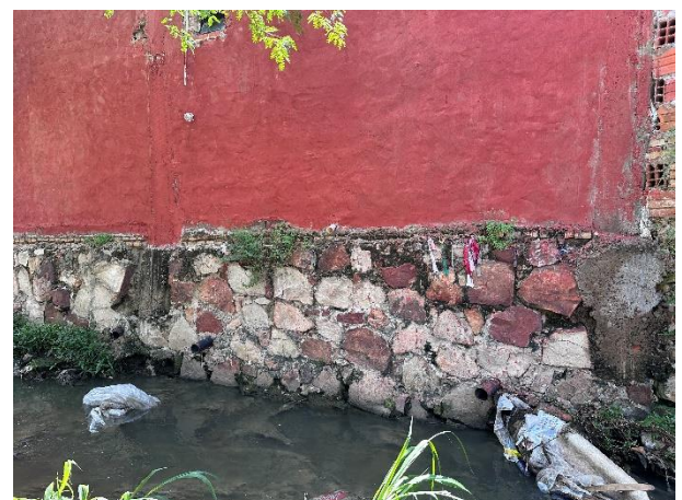
Foto 6: Caños de sanitarios con dirección al cauce
