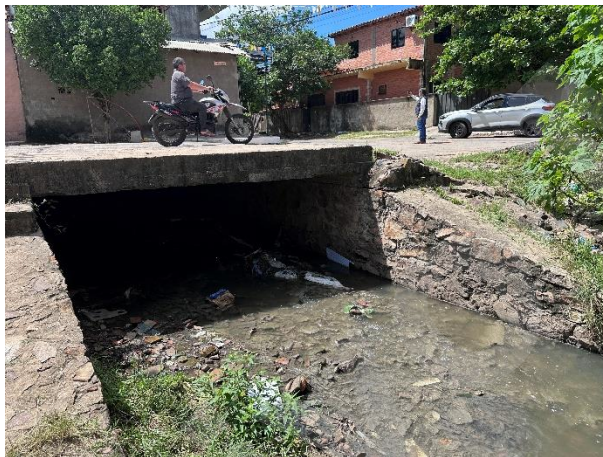
Foto 3: Recorrido de cauce pluvial con agua cloacales
