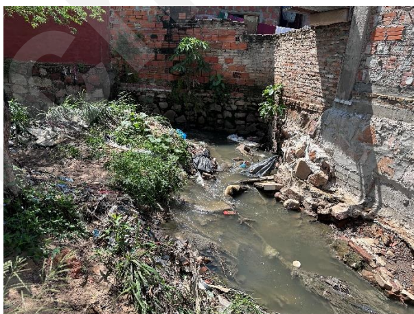
Foto 5: Recorrido de cauce pluvial con aguas cloacales
