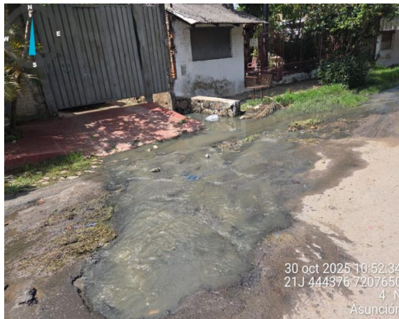
Foto 1: Caños rotos de aguas cloacales
