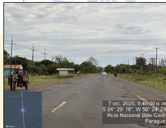
Deterioro de señalización vial
