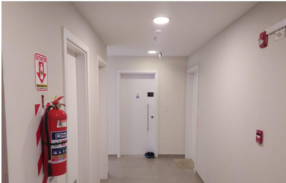
Vista de las áreas de los departamentos, se puede apreciar los equipos de combate y detección de incendios que se repite en los pisos restantes
