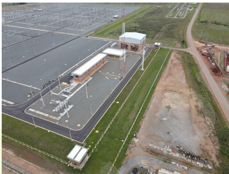
– Subestación Valenzuela 500 kV de la ANDE
