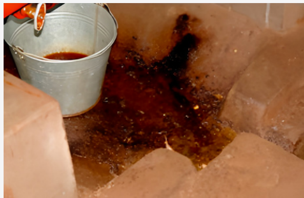
Figura 27: Detalle del piso de una planta de tratamiento de aceite
