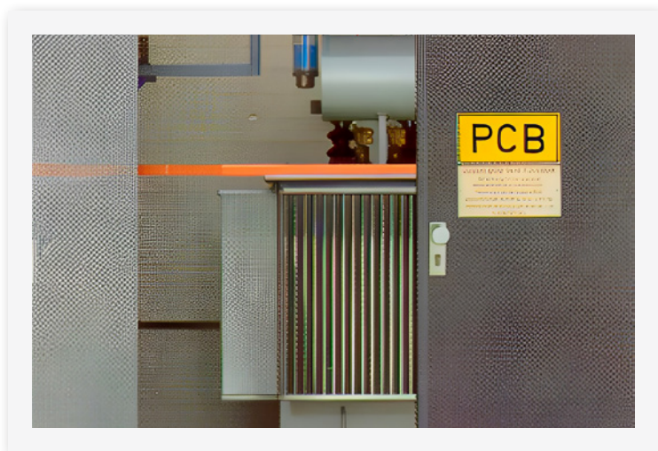
Figura 48: Señalización de una puerta de una sala conteniendo un Transformador
