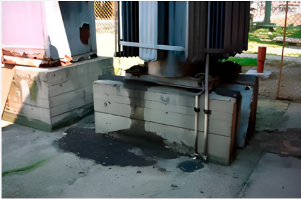
Figura 28: Derrame de un transformador sobre una pila de concreto
