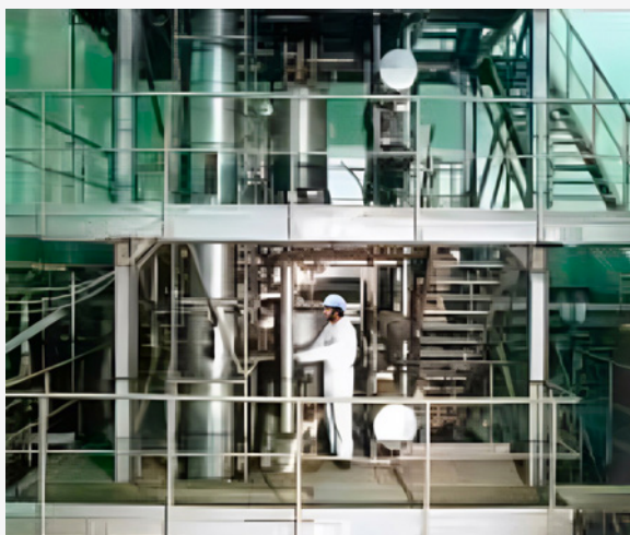
Figura 89: Planta de descontaminación LTR
