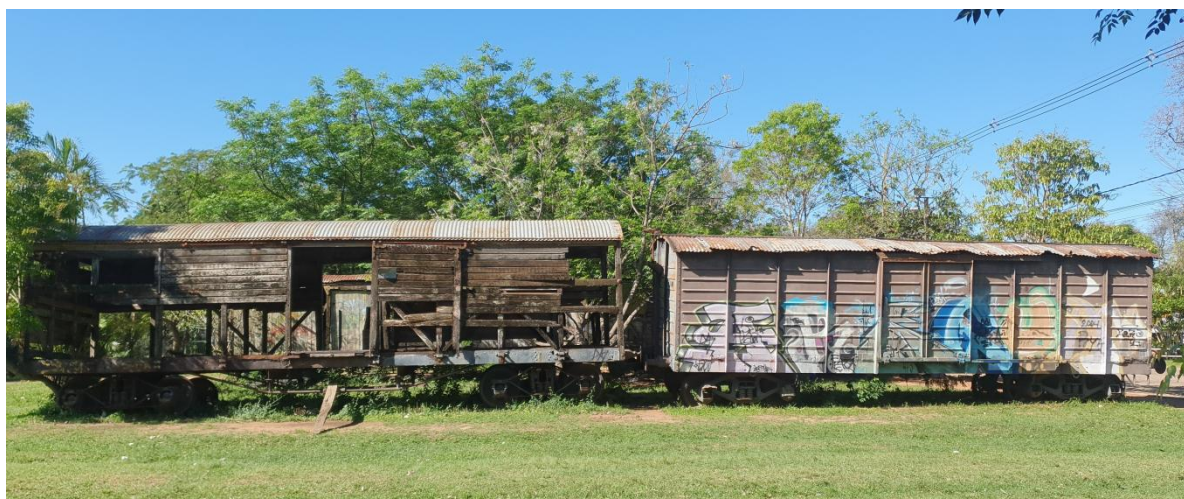
Figura 35 Vagones del antiguo tren, totalmente en mal estado de conservación (2023)
