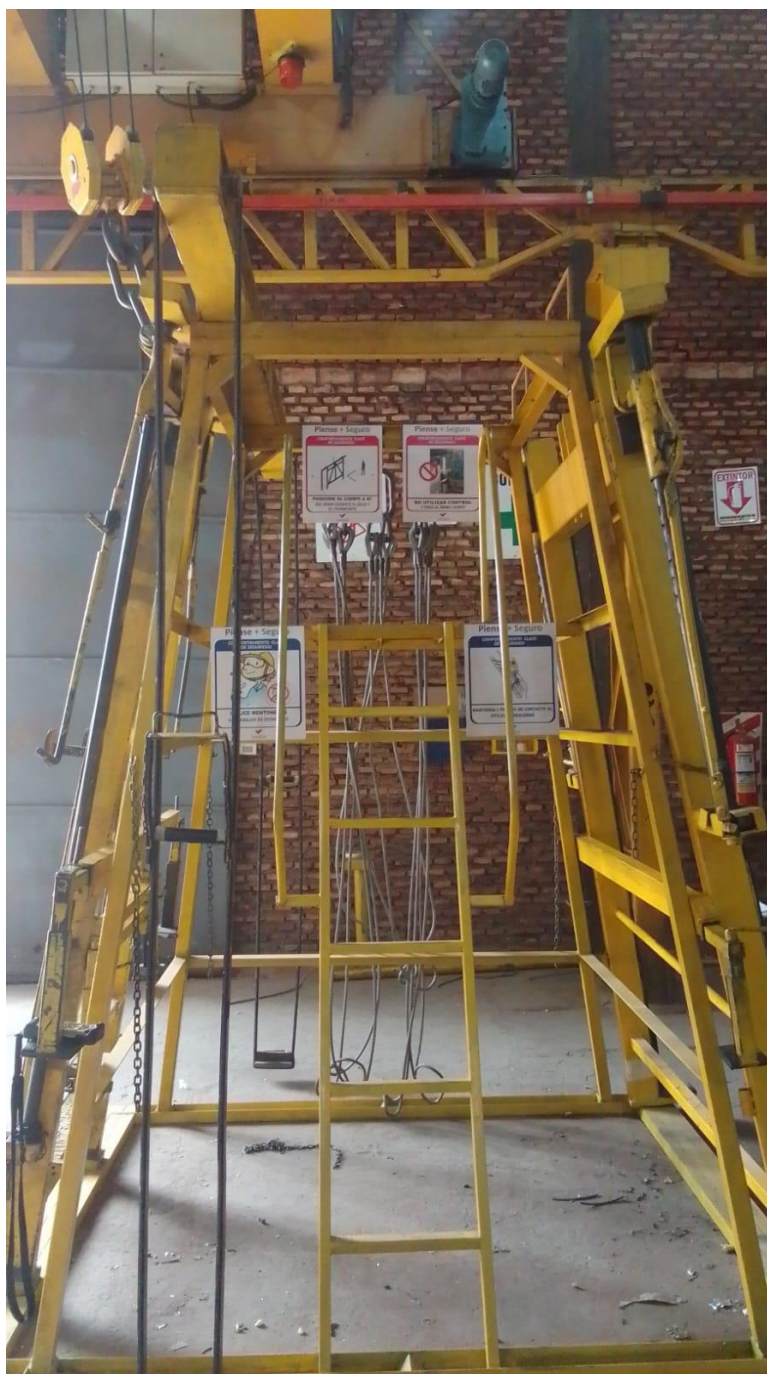
Instalaciones del puente grúa
