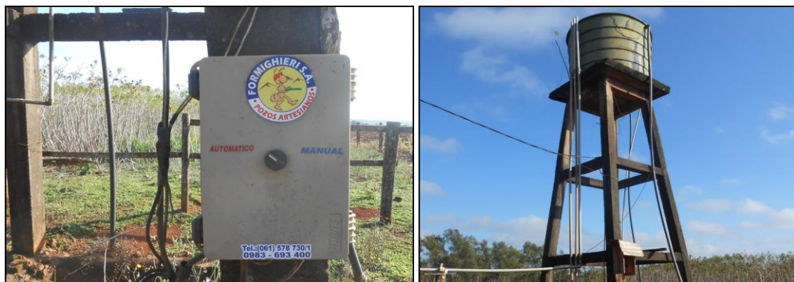
Fotos N° 17 y 18: Pozo Artesiano y Tanque de Agua.
