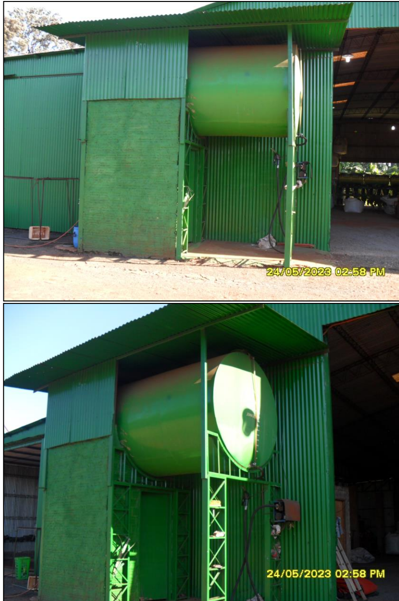
Fotos N° 10 y 11: Expendio de Combustible para Uso Propio.
