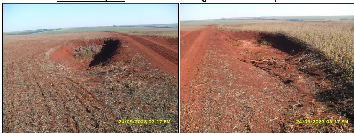
Fotos N° 20 y 21: Reductores de energía de escorrentía pluvial.
