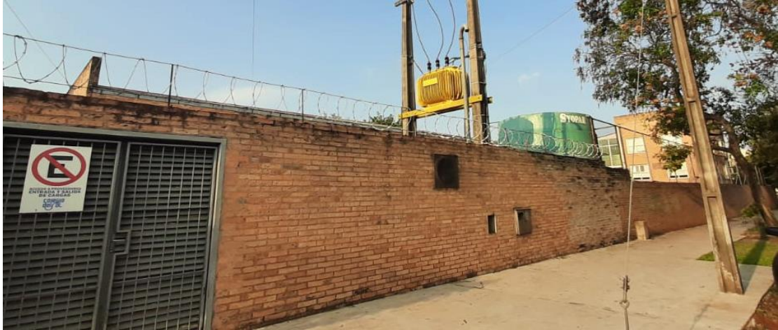
Foto 11: Las instalaciones del Colegio cuenta con transformador propio.
