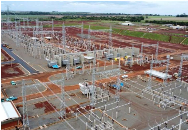
Ilustración N° 2 – Subestación Yguazú 500 kV de la ANDE
