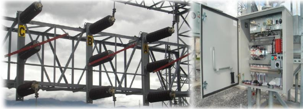
Ilustración N° 26 – Imagen de seccionadores
