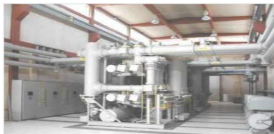
Ilustración N° 23 – Subestación. Equipos aislados en SF6
