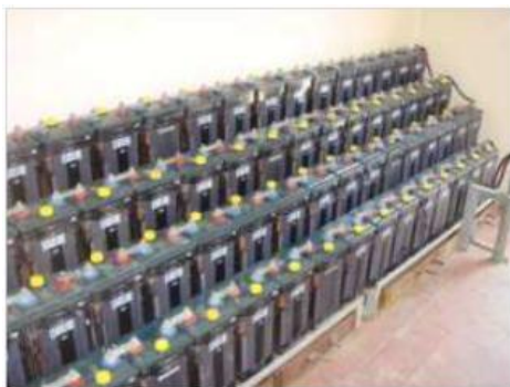
Ilustración N° 31 – Banco de baterías
