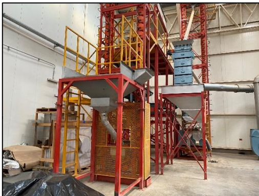
Fotografía N° 4. Maquina elevadora de granos para la maquina descortezadora
