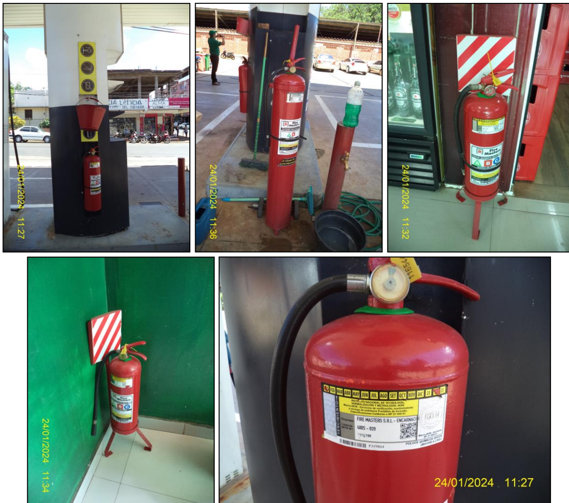
Fotos N° 14 al 18: Equipos de Prevención Incendios
