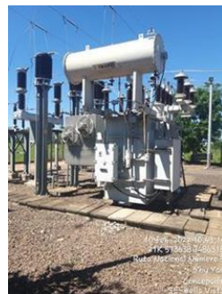
Foto 3: Vista general de transformadores – Patio de 66kV.
