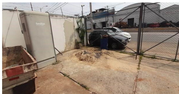
Foto 18. Caja séptica y pozo ciego.
