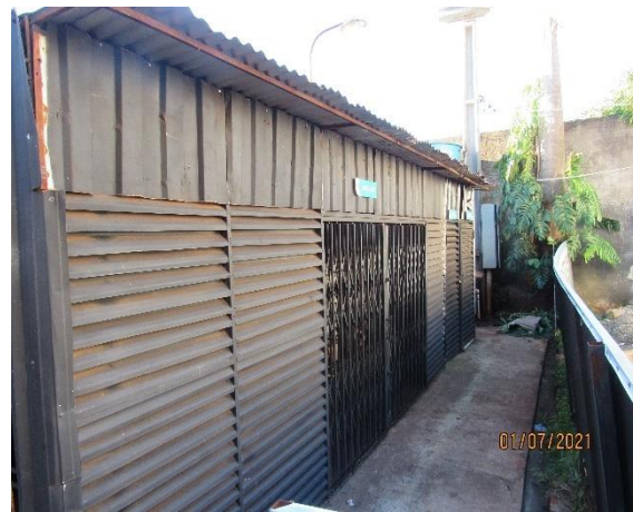
Área de generador
