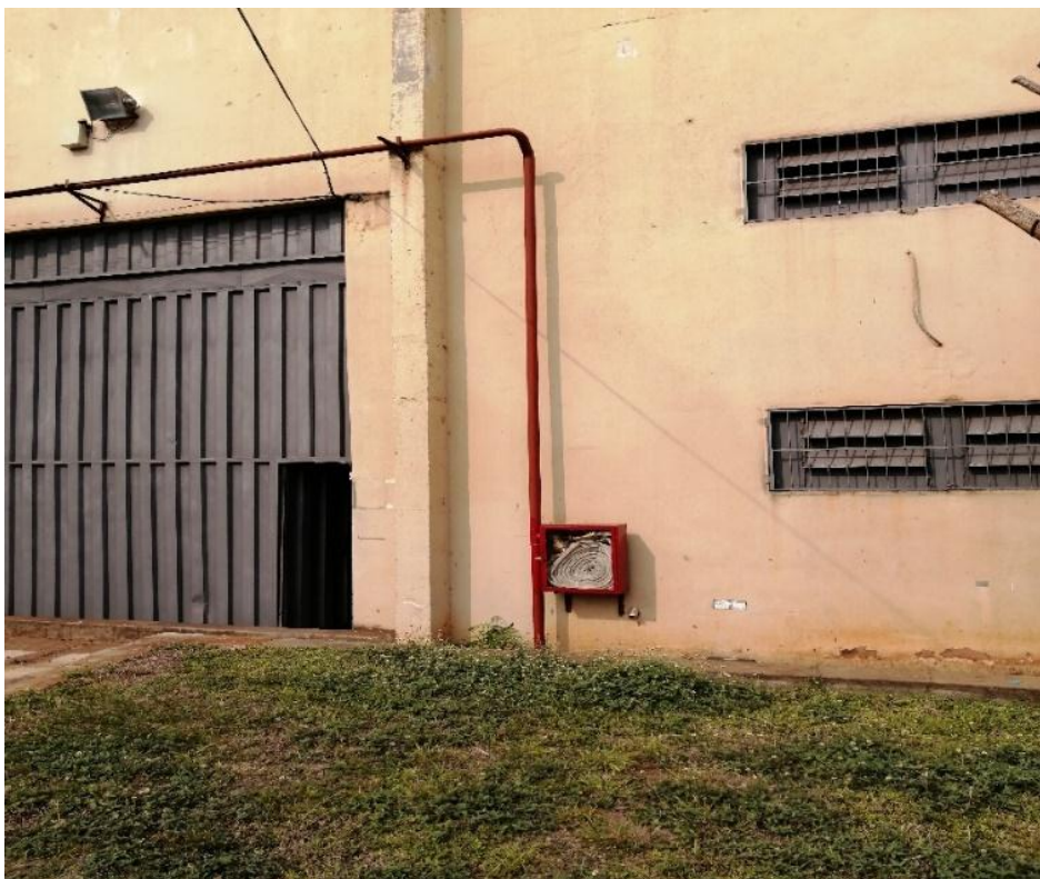
Señalización, extintor de incendios y boca de incendios
