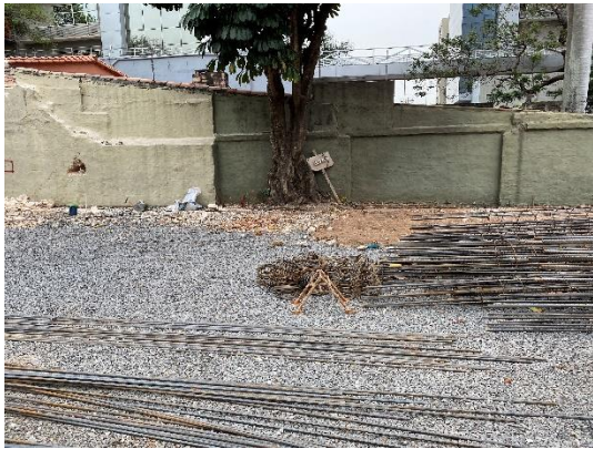
Foto 3: vista en el interior del predio, donde se observa el muro a demoler sobre la calle Dr. López Moreira.
