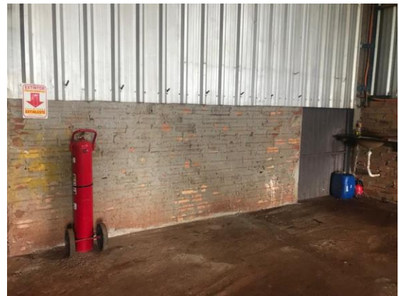
Fotografía 2. Uso de extintores contra incendios
