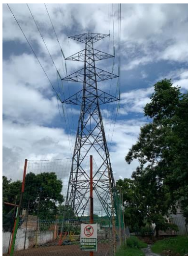
Imagen 3. Fotografía de la Torre de alta Tensión N° 19.
