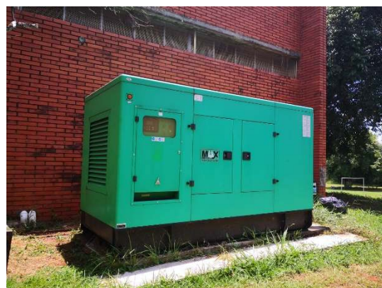
Generador para abastecimiento de zonas críticas
