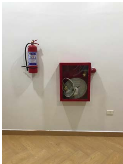
Ilustración 2. Vista de extintores de incendio de la Universidad Central del Paraguay Filial Pedro Juan caballero. Facultad de Medicina
