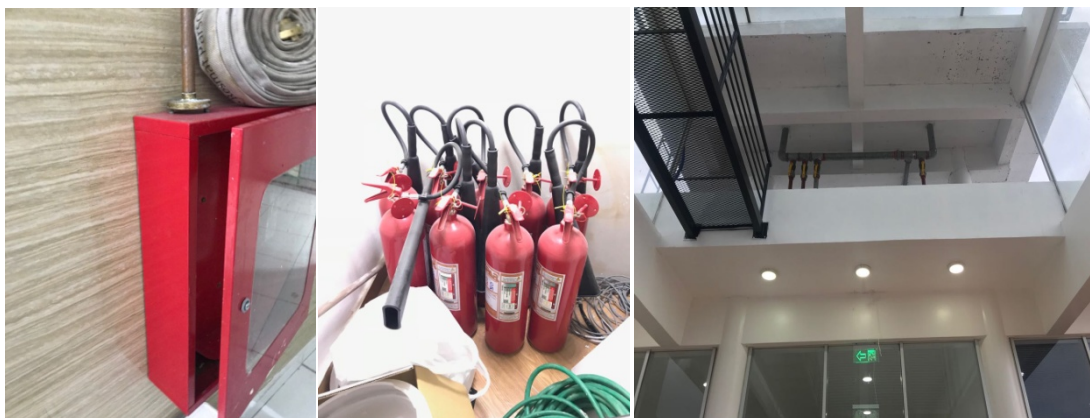
Ilustración 3 Vista de tanque de incendio,
