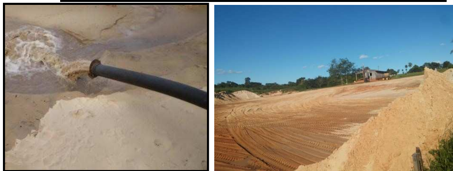
Foto Demostrativa: Caño de Expulsión y Pileta de secado
