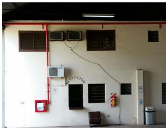
Tanque elevado (reservorio de agua), BIS, BIE y Extintor.
