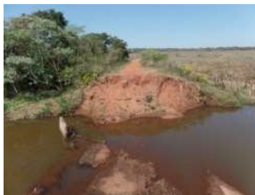
Fotografía 4. Puente de madera destruido, Aº Santa María, Misiones.
