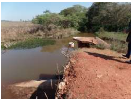
Fotografía 5. Estructura de puente destruida por contingencia climática. Aº Santa María
