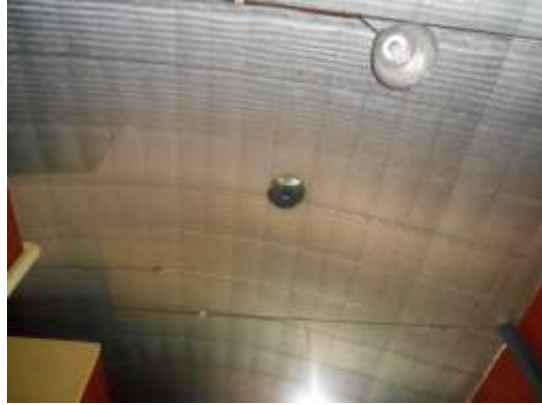
Techo con material aislante y extractores eólicos
