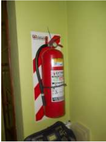
Extintor de Pared
